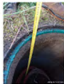
Foto 07a. Mirada desde el interior de la arqueta hacia el interior del tubo de PVC.
