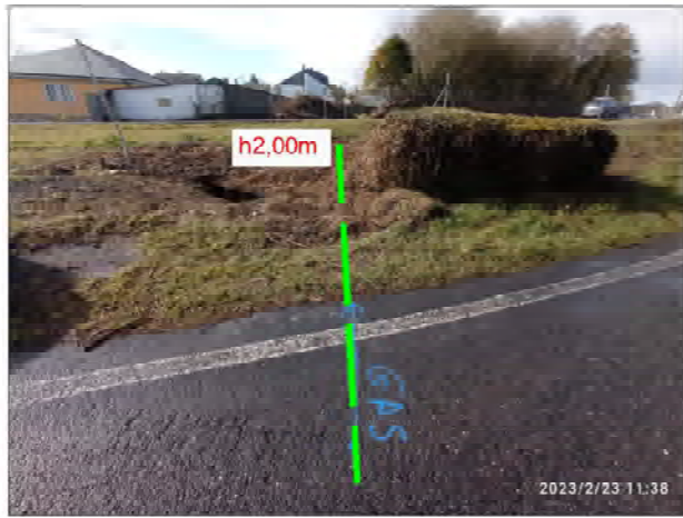
Foto 01. Dirección canalización hacia Ronda Norte. En esta vía ya alcanza los 2,00 m. profundidad
