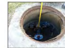
Foto 05a. Interior arqueta, generatriz superior tubo a 0,80 m. de la tapa
