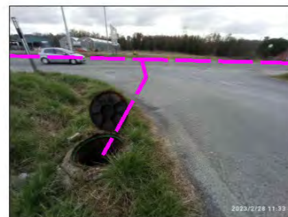
Foto 04a. Interior arqueta
