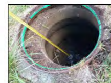
Foto 04a. Interior arqueta
