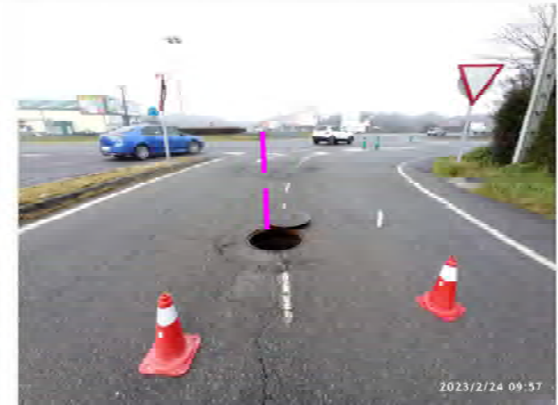
Foto 04. Cámara registro nº 286 a donde llega prisma 6TØ110 afectado por colector. Profundidad aprox. 1,40 m.
