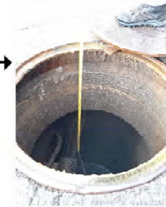
Foto 04a. Interior cámara registro nº 286
