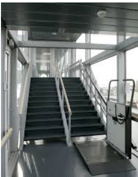
Un salvaescaleras permite acceder desde el portal al resto del edificio.
