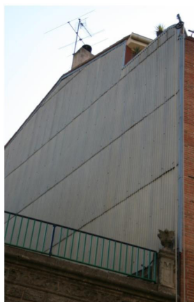
Medianera protegida con revestimiento de placas onduladas de fibrocemento.
