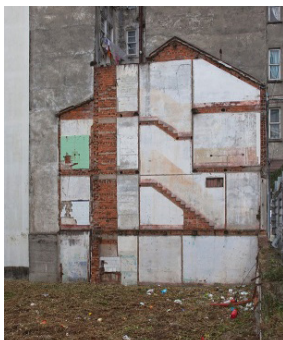
Medianera sin revestimiento tras la demolición del edificio colindante.
