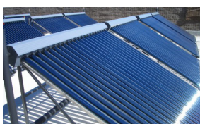
Captador solar de tubos de vacío.
