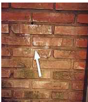
Manchas de eflorescencias en fábrica de ladrillo.
