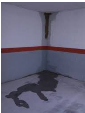
Aspecto del interior de un sótano con lesiones de humedad por infiltración.
