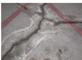
Eflorescencias por humedad capilar a través de una grieta en todo el espesor de una solera.
