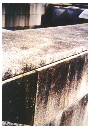
Manchas negruzcas sobre granito producidas por la colonización de algas y cianobacterias.
