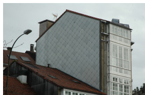
Medianera protegida mediante planchas lisas de fibrocemento.
