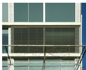
Lamas exteriores como sistema de protección solar en un edificio con grandes ventanas orientadas al oeste.
