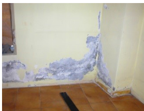
Aspecto del interior de un muro con lesiones de humedad por ascenso capilar.
