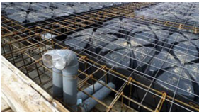
Bocas de tomas de aire exterior, para ventilar un suelo elevado con casetones plásticos.
