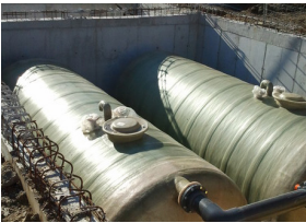
Tanques de almacenamiento de aguas grises.
