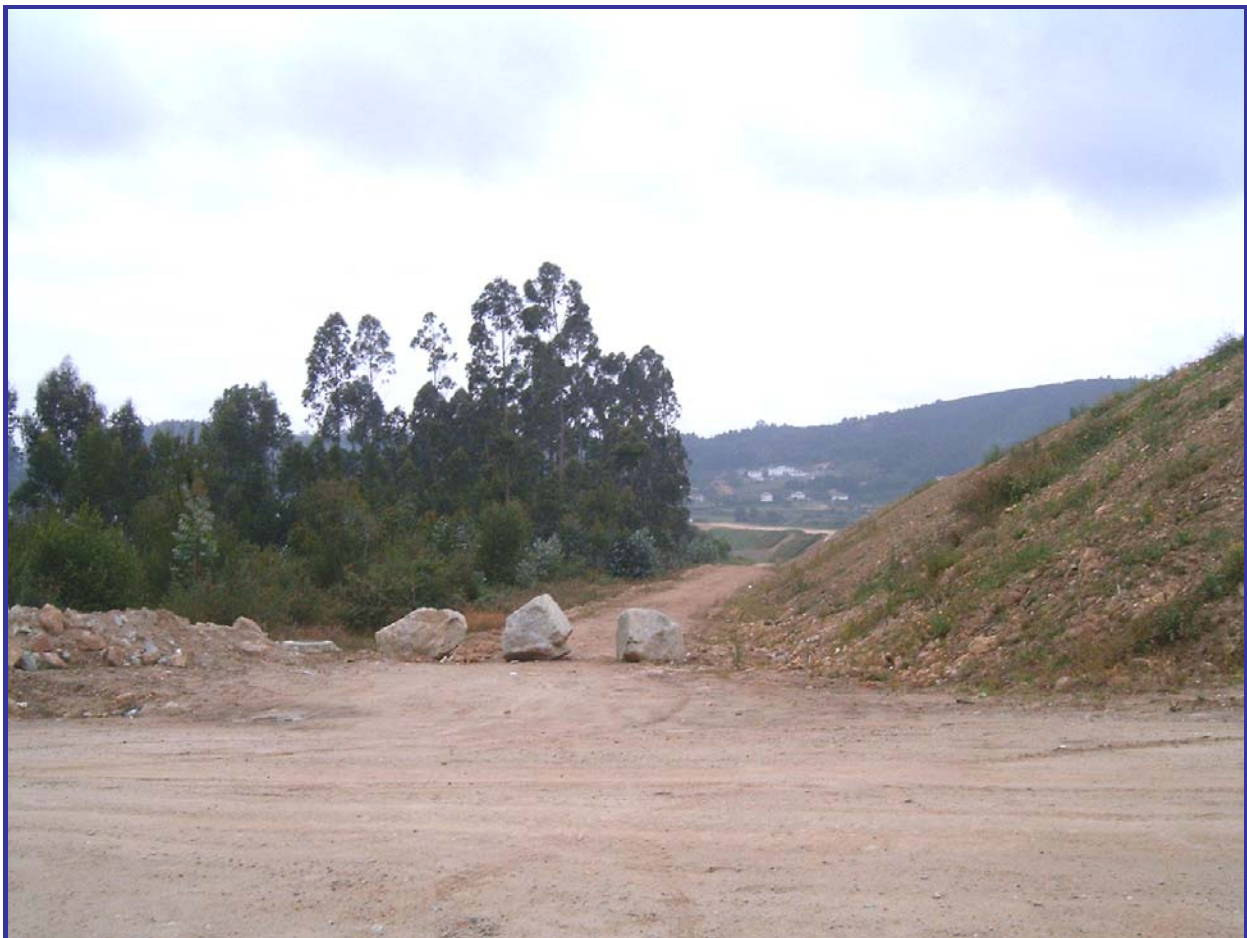
Vista general hacia el NW de la autovía en construcción en medio del futuro parque empresarial desde la finca de As Regueiras.
