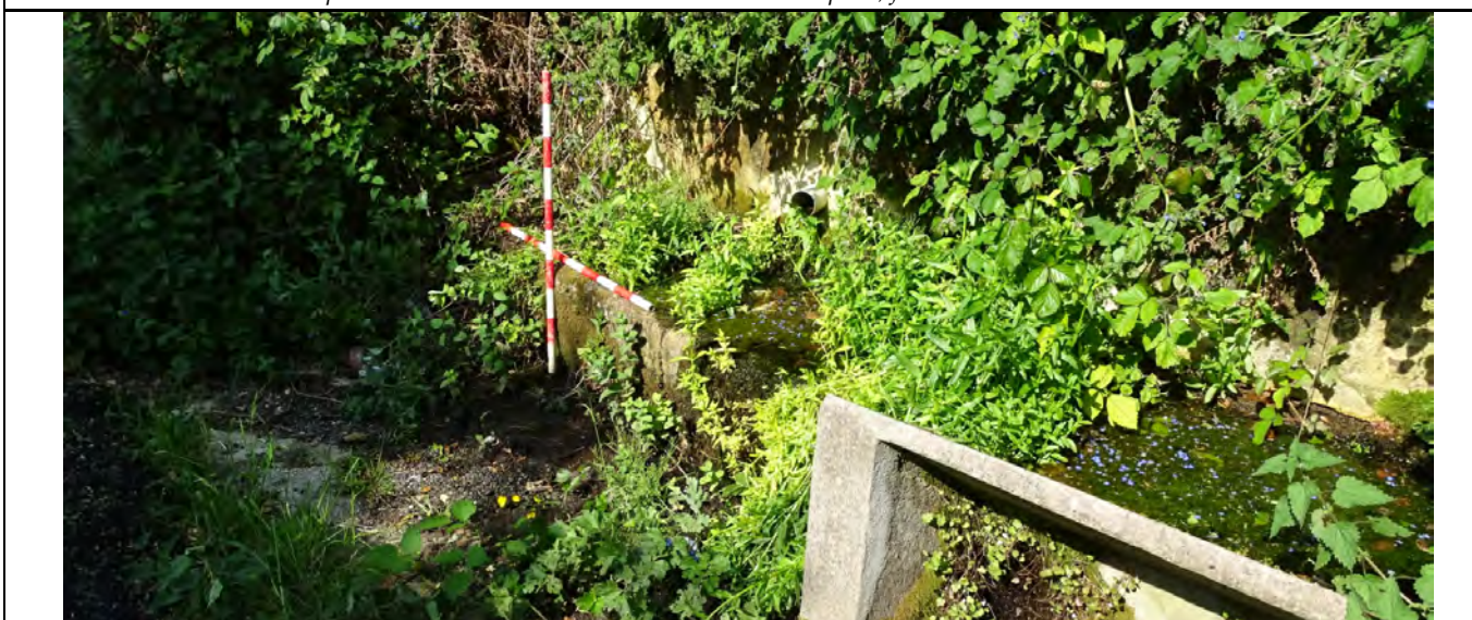
Detalle do estado actual do "Bebedeiro das bestas" e lavadeiro anexo. Vista dende OSO
