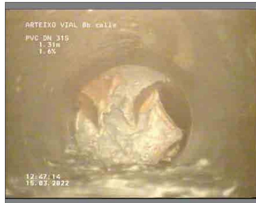
Foto: 9_9_38_A.JPG 1,31m, Se observa rotura de tubo con zoom
