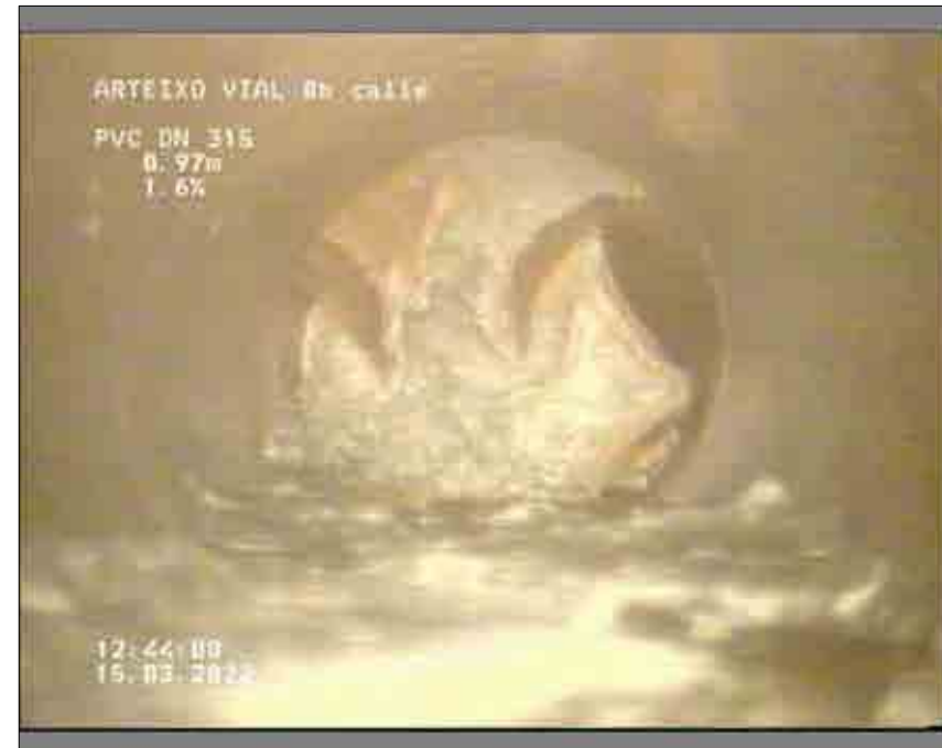
Foto: 9_9_36_A.JPG 1,31m, Roturas. Faltan trozos desde 12 hasta 12 horas
