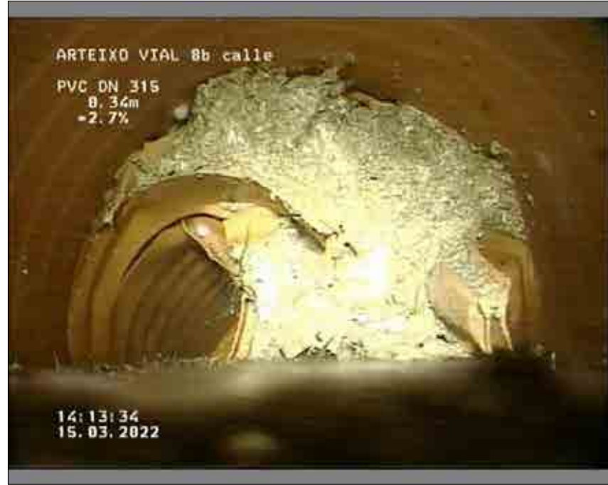
Foto: 14_14_52_A.JPG 0,34m, Roturas. Faltan trozos desde 12 hasta 12 horas
