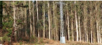
Línea aérea eléctrica
