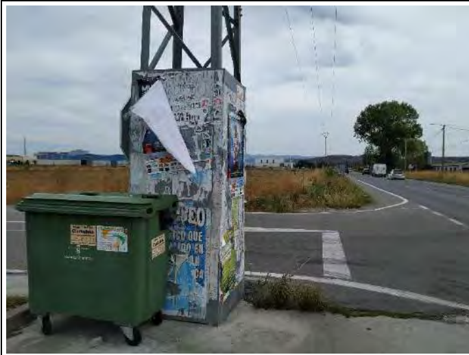
FOTO Nº05: Torre de Alta Tensión hasta donde se tendrá que enterrar la actual línea aérea (paso de aérea a subterránea)
